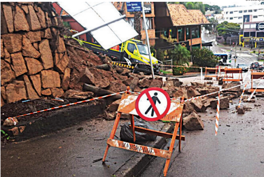
Muro caiu na São Lázaro, após as fortes chuvas registradas em Jundiaí
