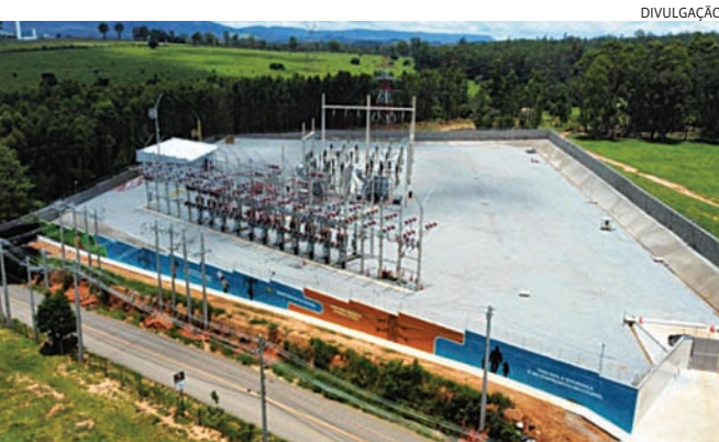
A nova estrutura amplia a capacidade do sistema elétrico
