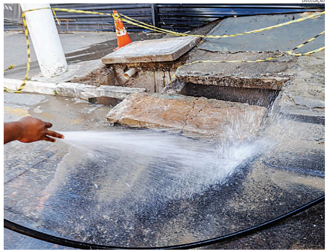
A ‘nata de cimento’ caiu na galeria durante lavagem dos EPIs
