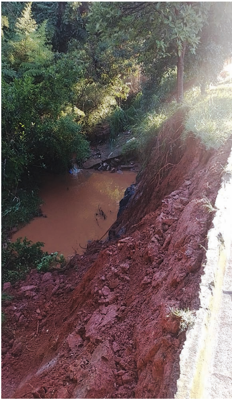
Deslizamento de terra foi registrado no bairro Cidade Nova 1
