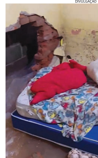
A força da água causou o desabamento da parede da casa da Marinete
