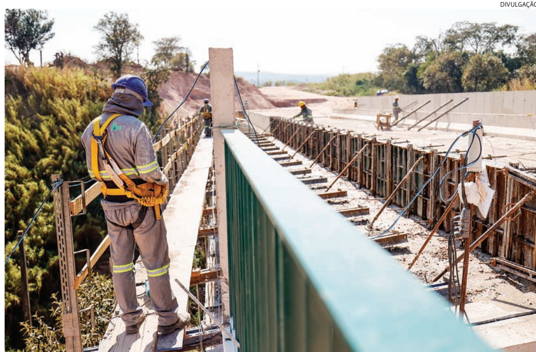
A obra, quase pronta, segue para a construção da avenida de interligação com o bairro
