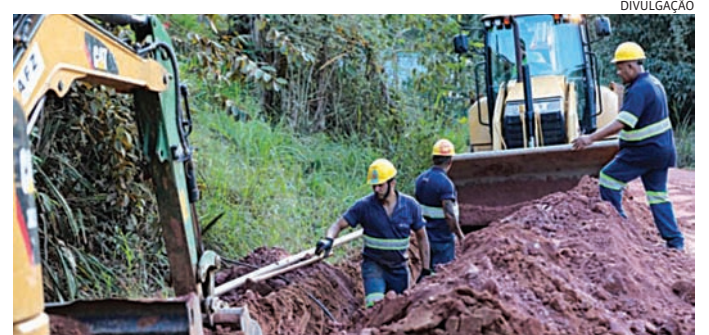
Após a conclusão das redes de água, a Dae dará início ao esgoto
