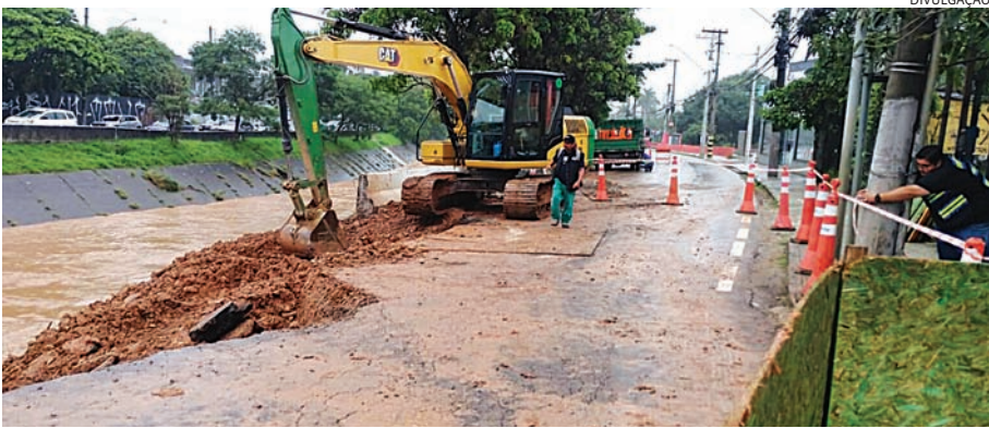
Erosão na margem do Rio Jundiaí compromete trecho da avenida Ozanan
