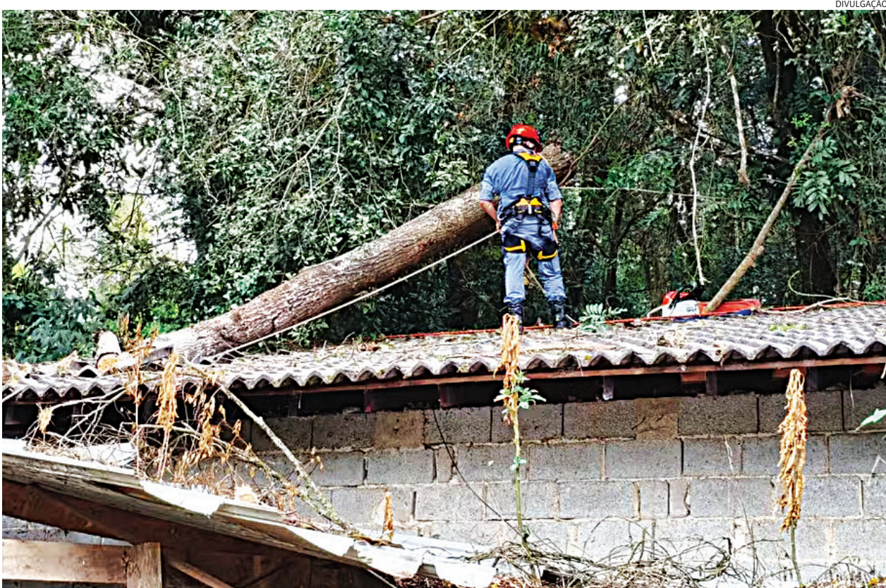
Em Várzea Paulista, árvore cai em telhado de casa
